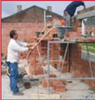
Eintönige Arbeit: Umfüllen des Mörtels mit der Schaufel aus der Schubkarre am Boden
